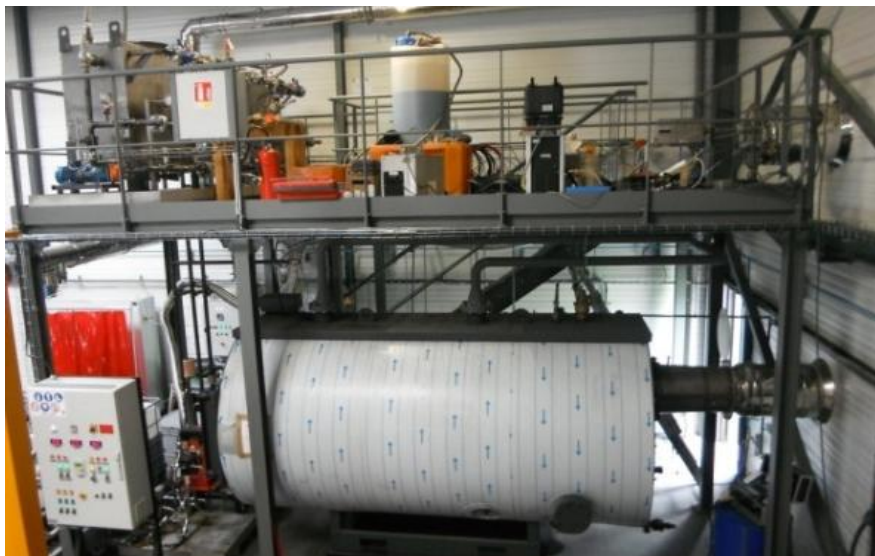
Chaudière de 2 MW pour test de combustibles liquides
