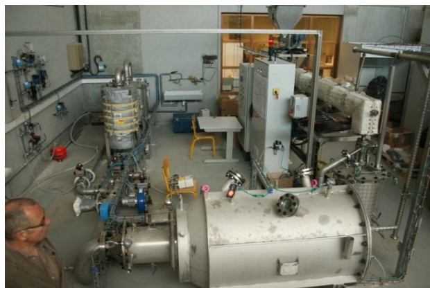
Banc d'essais pour l'étude du traitement des terres contaminées et de la pyrolyse de matières hydrocarbonées mis en place par ATANOR chez PROVADEMSE
