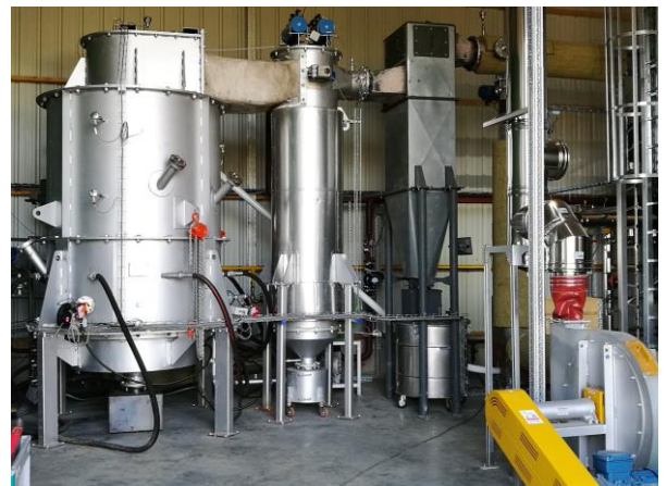
Sous-ensemble « foyer - chaudière - multicyclones »
