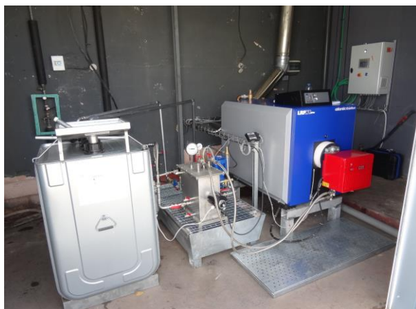
Chaufferie de 125 kW mise en place en Guadeloupe chez Les Flandres par ATANOR
