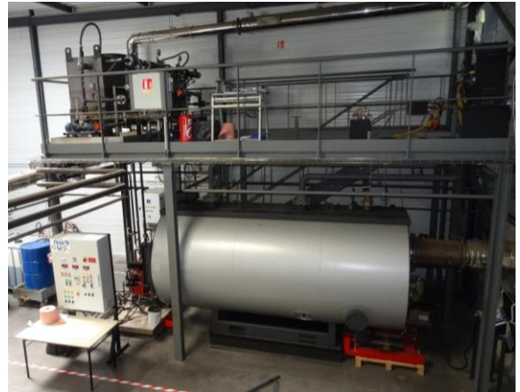
Chaudière d'essais de 2 MW d'ATANOR
