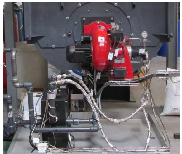
Chaudière d'essais de 2 MW d'ATANOR (vue du brûleur)
