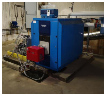
Chaudière à fuel domestique convertie aux HAU
