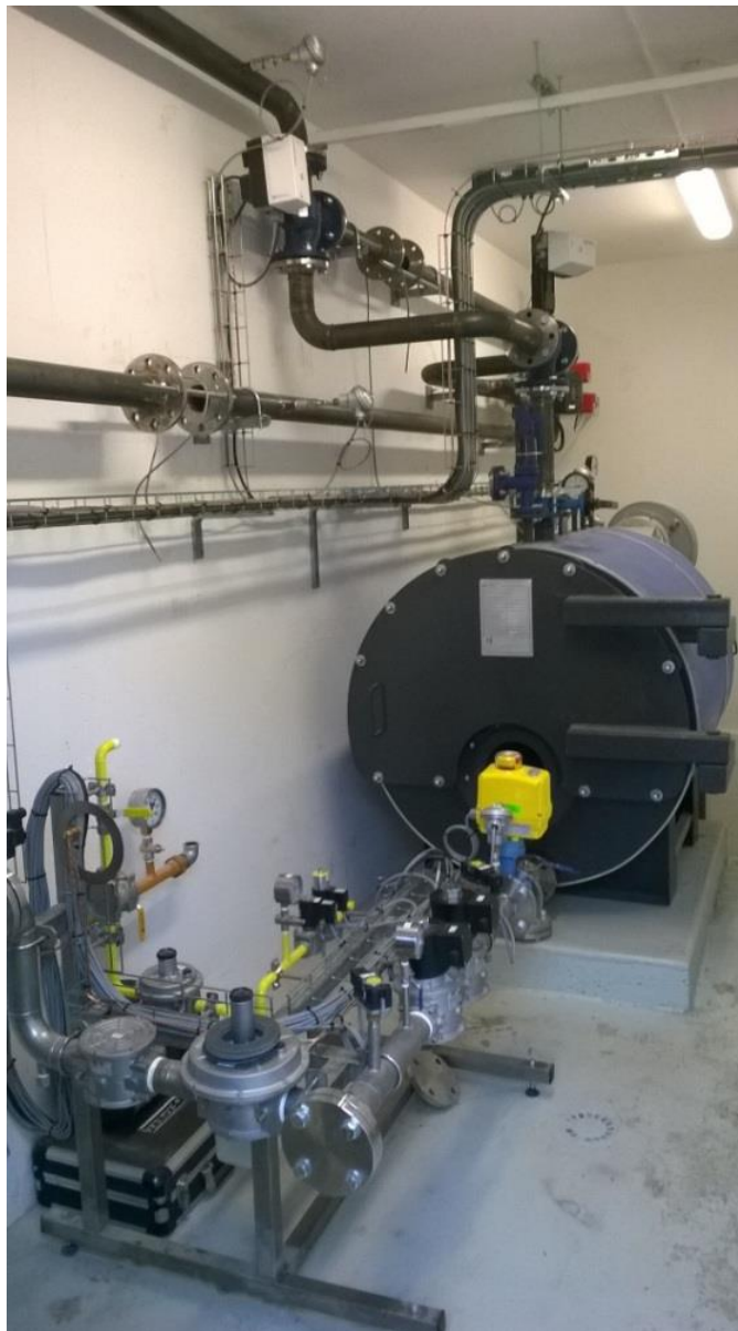
Chaudière de 250 kW pour valorisation de syngaz
