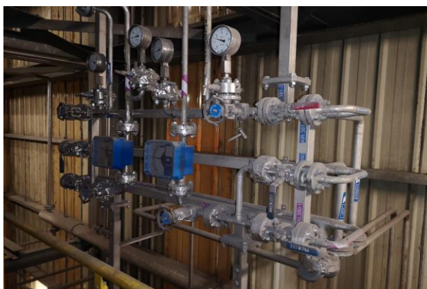
Panoplie de contrôle de l'injection d'agent DeNOx
