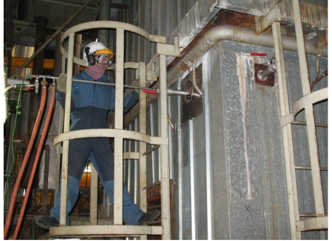
Etablissement d'une cartographie des températures dans le foyer d'une chaudière « fuel »
