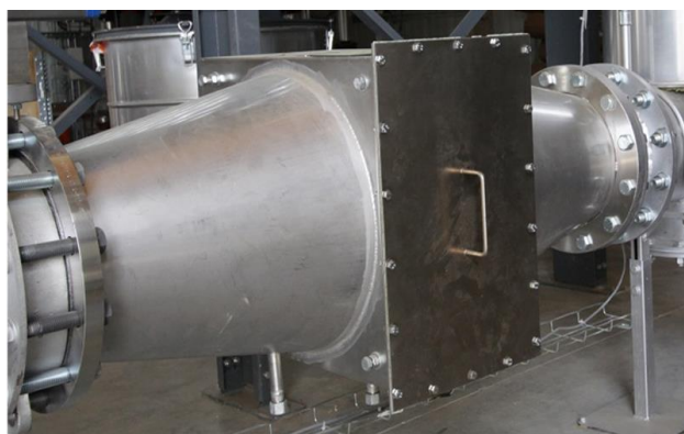
Réacteur DeNOx catalytique sur chaudière
