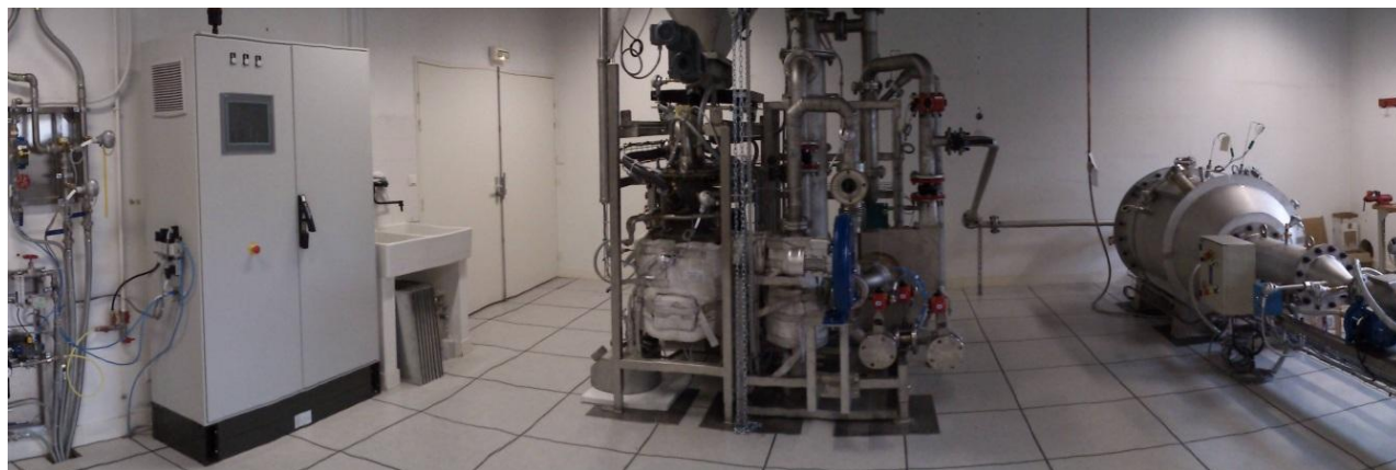
Gazéifieur de biomasse pour travaux sur l'épuration du syngaz par réacteur « plasma »
