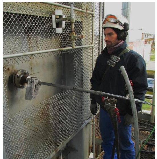
Mesure de température dans une chambre de combustion au pyromètre à aspiration sur un four
