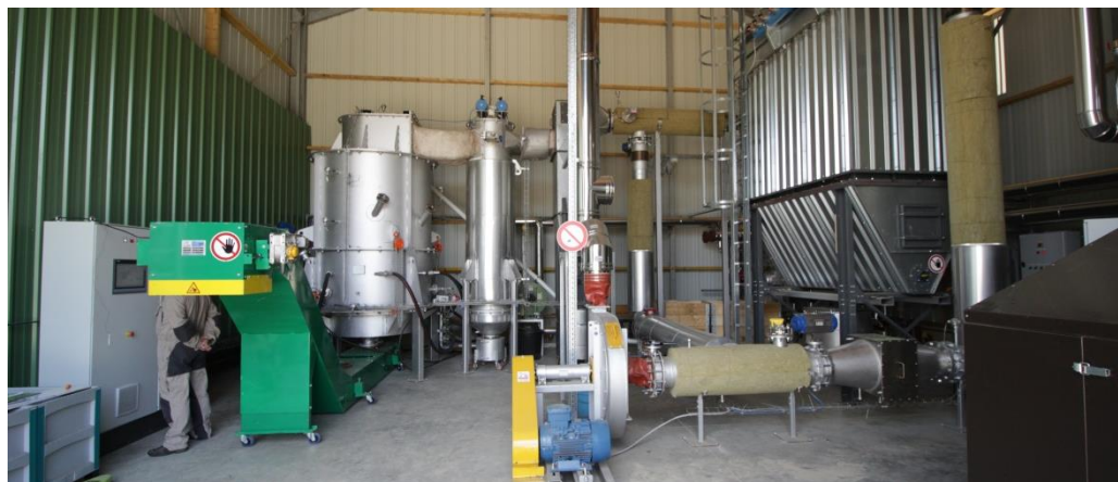
Prototype de chaudière à litières mis en place chez un éleveur de volailles partenaire
