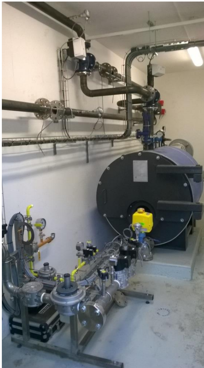
Chaudière de 250 kW pour valorisation de syngaz
